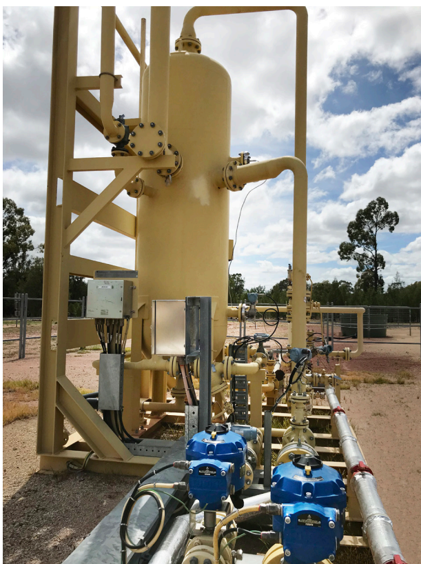
Figure 2. Rotork CVQ actuators on an LNG site in Australia.
