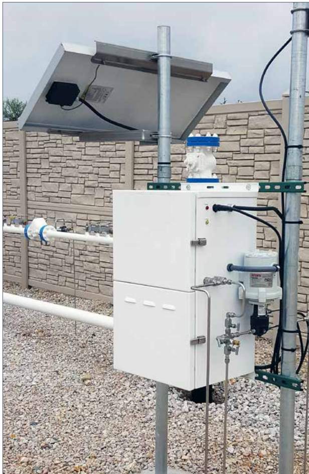
PAX 1 安装在太阳能远程压力控制站上
