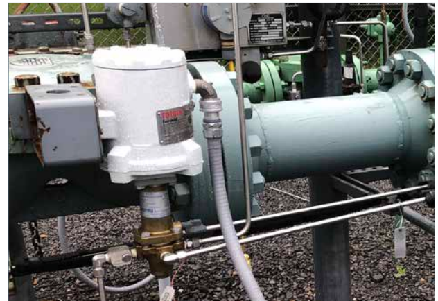
PAX 1 安装在天然气分配用压力控制和计量站上
