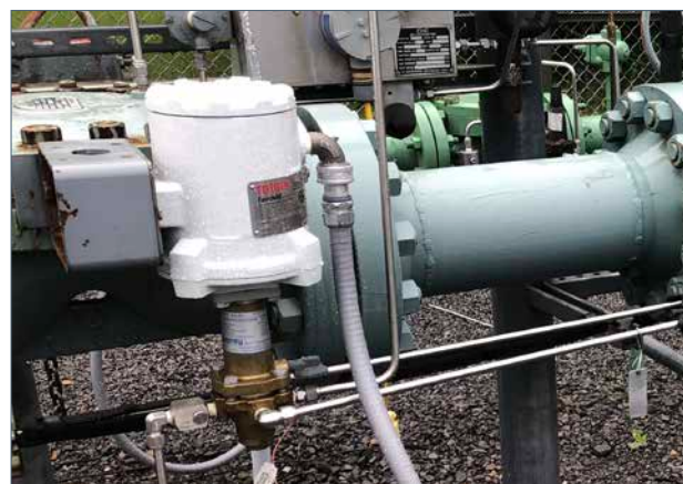
PAX1 установлен на контрольно-измерительных станциях давления для подачи природного газа
