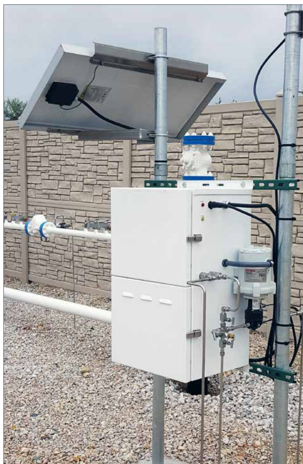
PAX1 установлен на удаленной станции контроля давления на солнечных батареях
